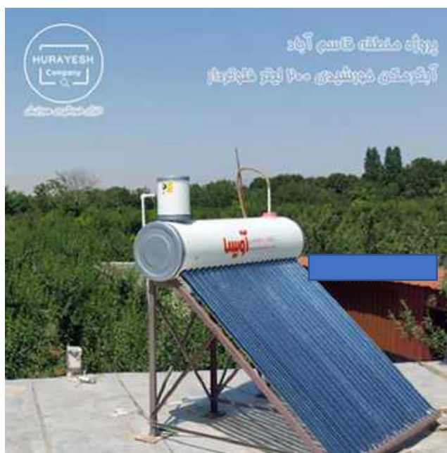
شکل ۳) آبگرمکن خورشیدی نصب شده بر روی پشت بام منزل.
